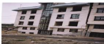
عکس ۱: تجاوز به حریم رودخانه فرحزاد و اثر لغزش بر عملیات ساختمانی
